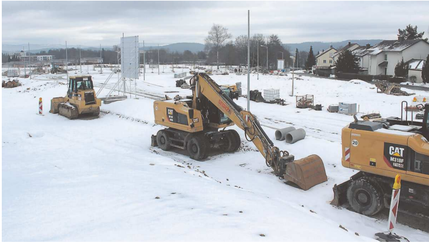
Noch herrscht Winterruhe auf dem alten Krankenhausgelände. Doch die Bagger stehen bereit für den Baubeginn im neuen Wohngebiet Eschelen. 370 Wohnungen haben sechs Immobilienfirmen dort geplant und die Nachfrage ist lebhaft. Foto: Berthold Merkle
